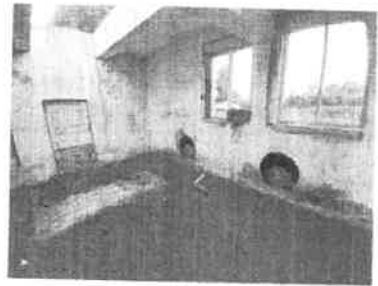
statie de pompare rasova (6)
