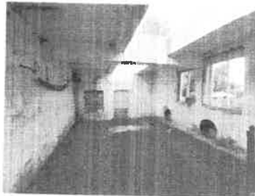
statie de pompare rasova (5)
