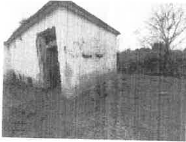
statie de pompare rasova (4)
